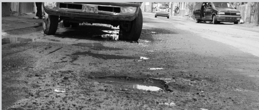
En la mayoría de las colonias con la problemática, ya no parece bastar con bacheo, sino que se requiere una rehabilitación total.
