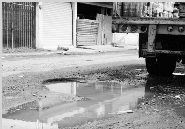
La llegada de las lluvias incide directamente en el incremento del problema.
