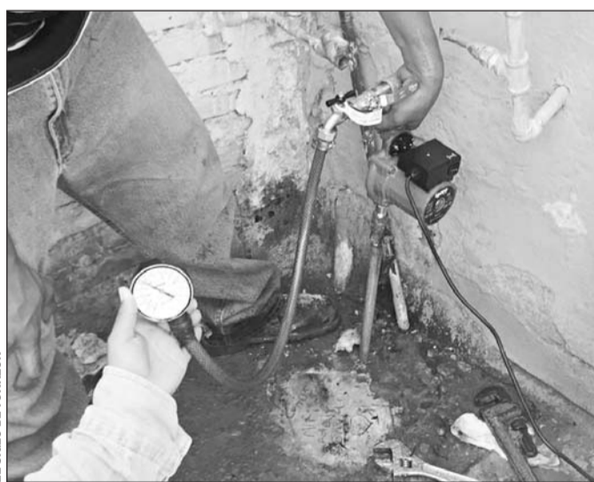
Instalación. Los usuarios pueden solicitar su inscripción a este programa, al teléfono del organismo operador de agua, 7-15-69-69.
