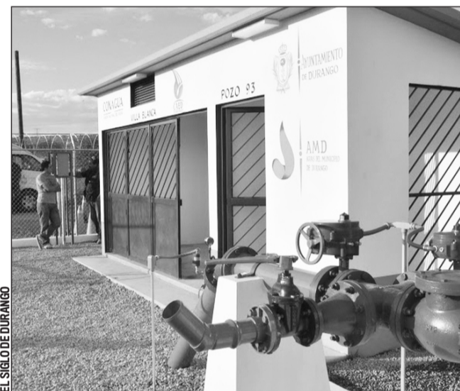
Pozos. Todos los pozos de agua tendrán su alarma para que en segundos se pueda detectar cuando se apaguen.
