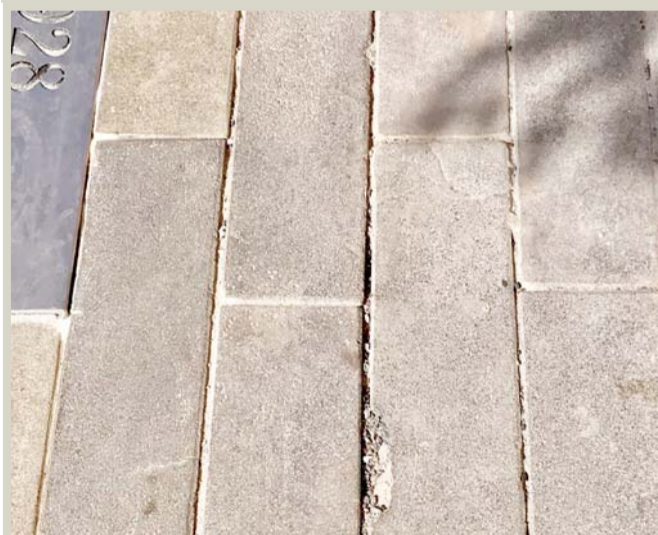
Por lo que se observa, el material que se utilizó para la banqueta es demasiado frágil.
