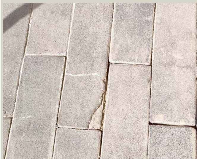
A muy pocos días de que se puso en funcionamiento el Paseo Dolores del Río, su banqueta ya muestra daños.
